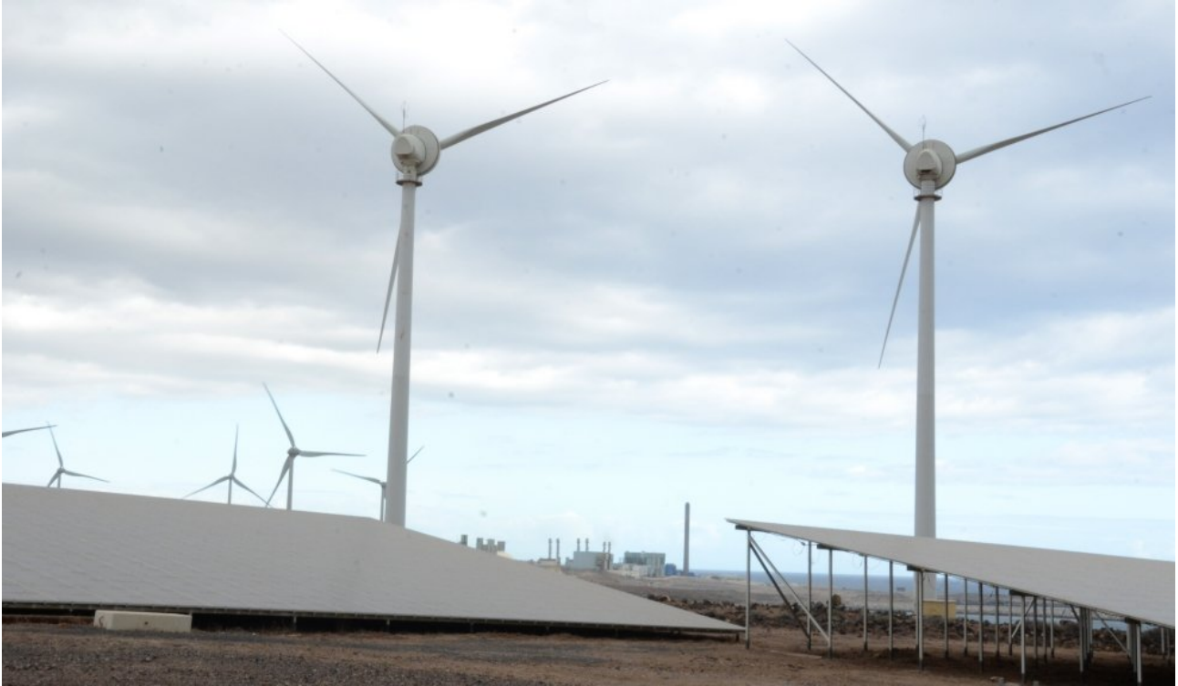
Sistemas de generación de corriente eléctrica en Granadilla, Tenerife.
